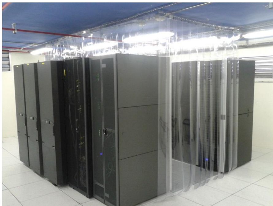
Figura 3. Sala Técnica del Centro de Procesamiento de Datos de la E.T.S.I. Informáticos de la UPM.
